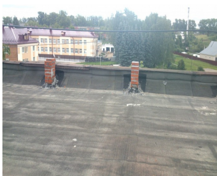
Кровля многоквартирного дома №1 по улице Строителей в поселке Садовый Суздальского района ДО капитального ремонта
