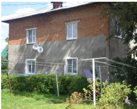
Фасад многоквартирного дома №2 по улице им. В.А. Солоухина в селе Черкутино Собинского района ДО капитального ремонта
