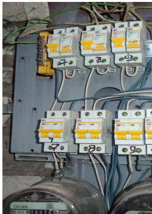
Система электроснабжения многоквартирного дома №3 по улице Чекунова в селе Фоминки ПОСЛЕ капитального ремонта
