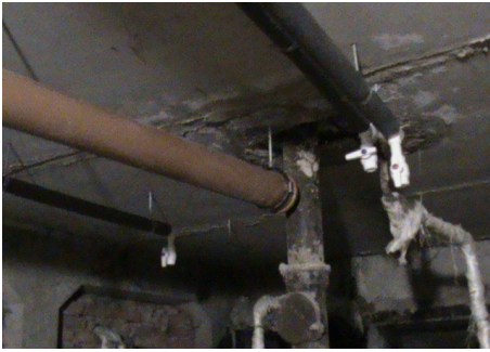
Внутридомовые инженерные системы многоквартирного дома №8 корп. 1 по улице Терешковой в городе Александрове ДО капитального ремонта
