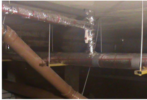
Внутридомовые инженерные системы многоквартирного дома №8 корп. 1 по улице Терешковой в городе Александрове ПОСЛЕ капитального ремонта
